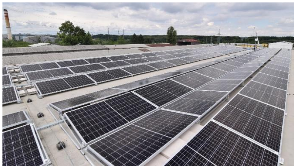
fotovoltaický systém 400 kWp (2000 m 2 )
