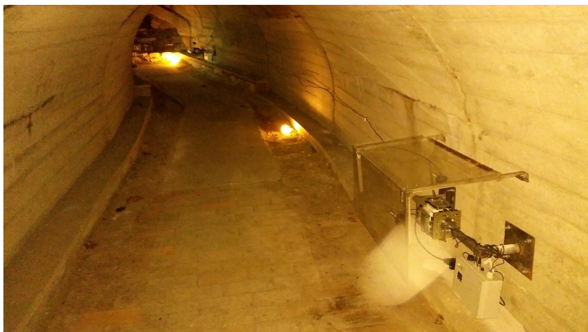
Obr. 10. Nainstalovaný přístroj TM-71 (přístroj LIT2 – Litoměřické podzemí)
